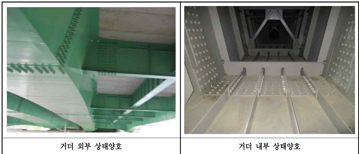
【사진 19.3.5】 거더 손상현황
