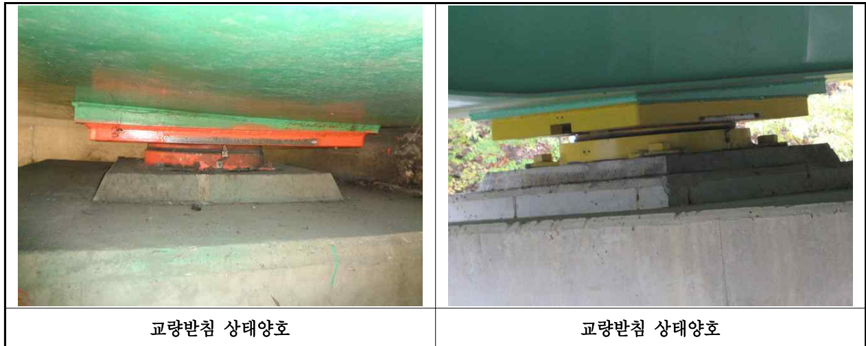
【사진 19.3.13】 교량받침 손상현황
