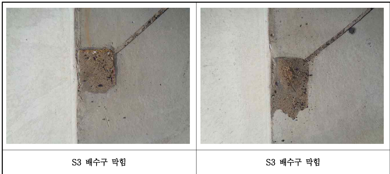
【사진 19.3.22】 배수시설 손상현황
