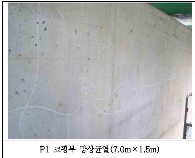
【사진 19.3.11】 교각 손상현황
