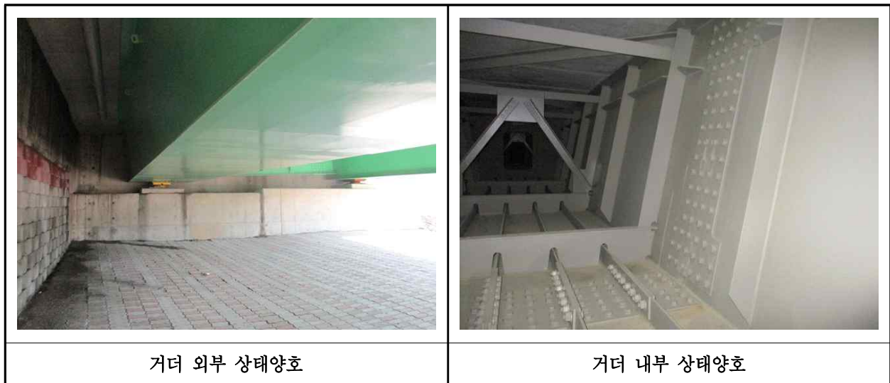
【사진 19.3.28】 거더 손상현황
