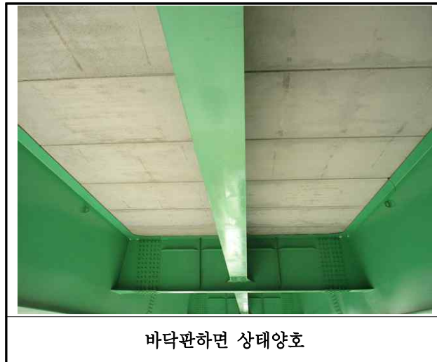
【사진 19.3.26】 바닥판하면 손상현황
