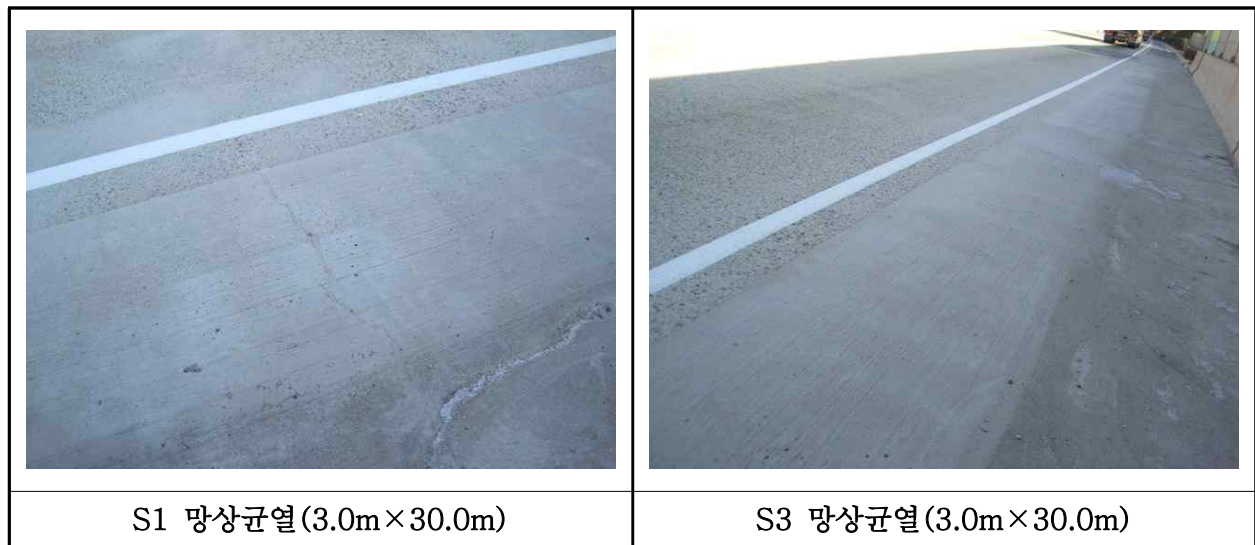
【사진 19.3.43】 교면포장 손상현황
